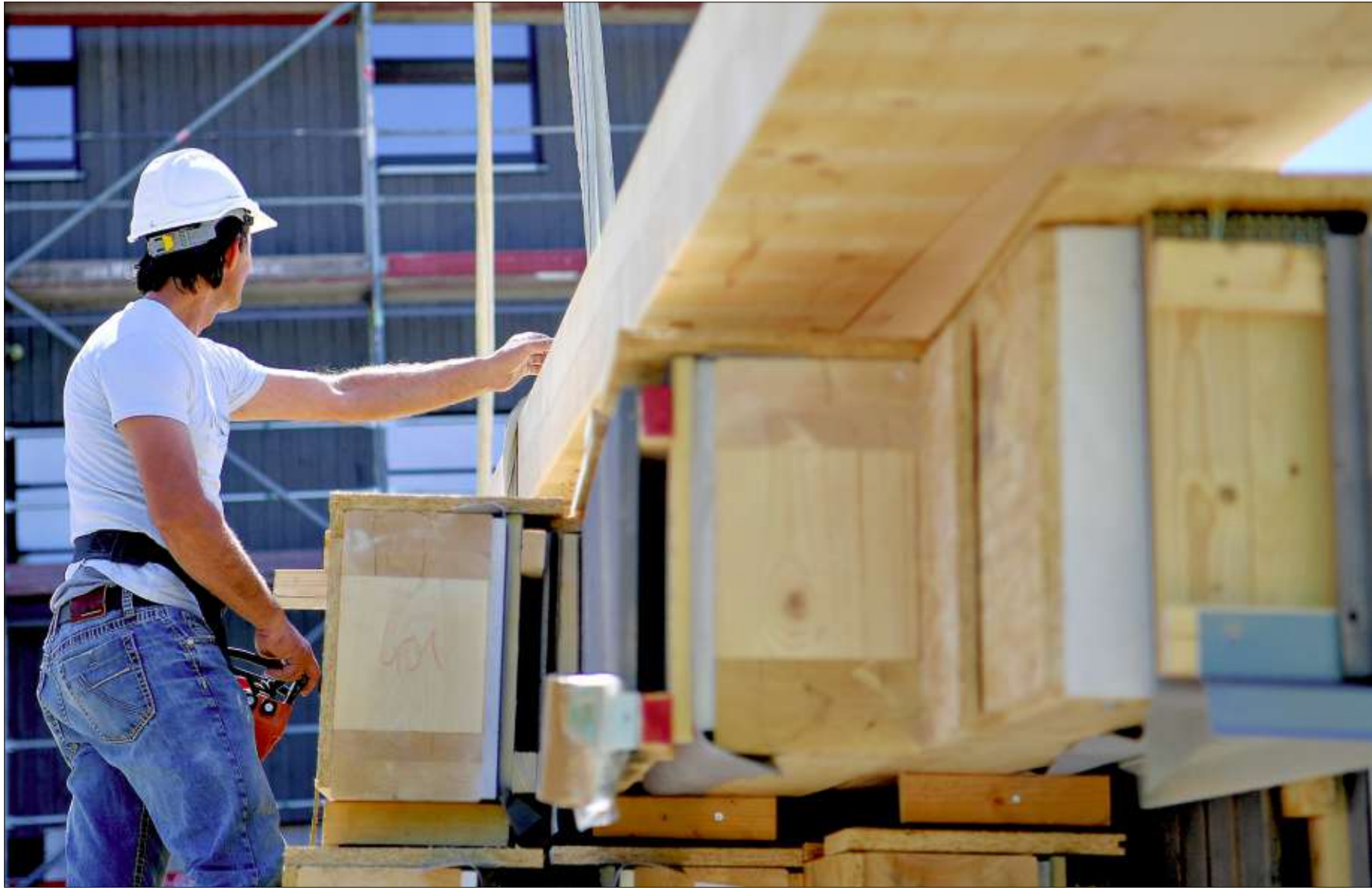
Die Preise für Baustoffe sind gestiegen, gerade mit Blick auf Holz und Kunststoff. Das macht neben dem Baustoffhandel auch und gerade den hiesigen Handwerksbetrieben in der Altmark zu schaffen.
