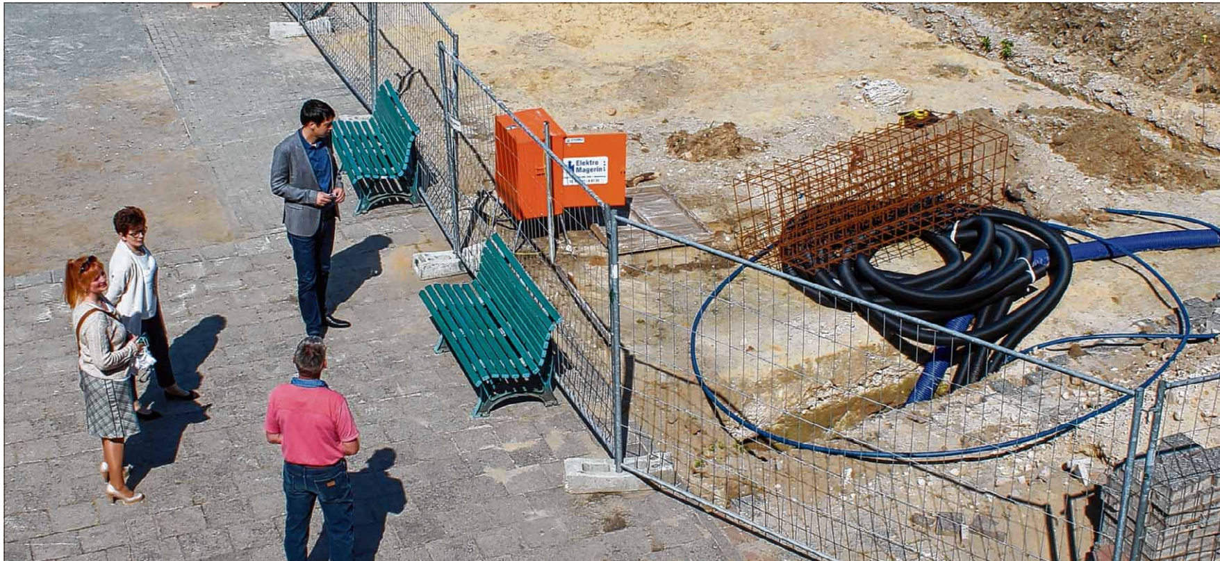
Aktuell laufen die Pumpen, um das Grundwasser abzusaugen. Bismarks Bürgermeisterin Annegret Schwarz, Schulleiterin Birgit Smirnow, Landrat Patrick Puhlmann sowie Hausmeister Ralph Stüwe sahen sich die Baustelle an. Foto: R.-M. Wienecke
